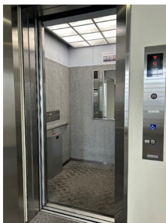
② エレベーター
