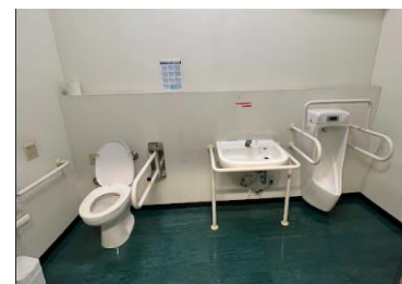
⑥1Fトイレ (車いす)
