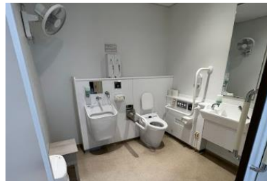
⑤1Fトイレ (車いす、オストメイト)
