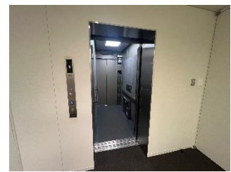
②エレベーター
