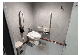
㉕5Fトイレ(女子、車いす)
