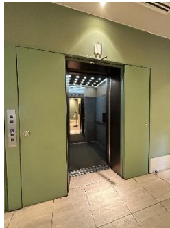
②エレベーター
