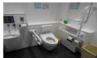
⑥ IFTトイレ (車いす、オストメイト)
